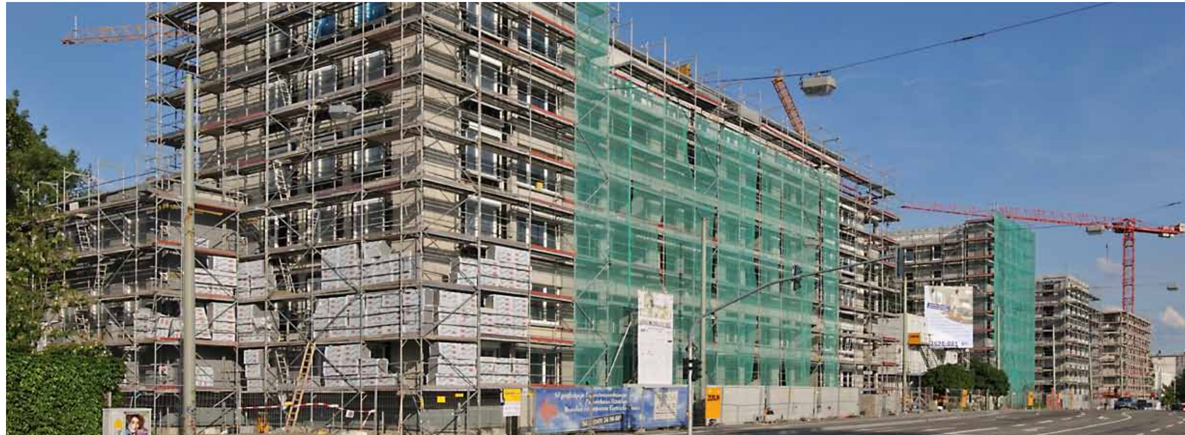
Passivhausbauweise: HANSA ALLEE WESTEND
